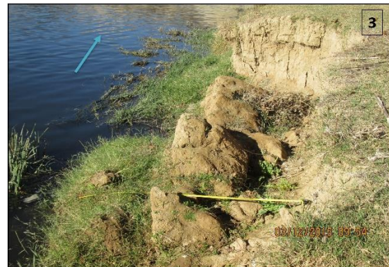
3- Effondrement des matériaux rive droite au Nord-Ouest du douar Zkara
