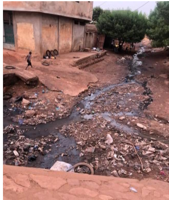
Photo : état de la rue
