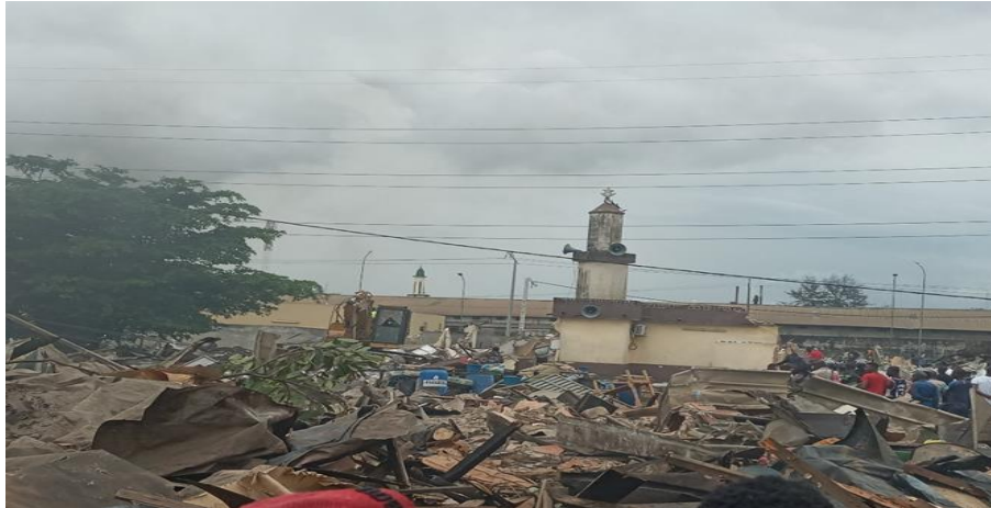
Indiqué 1 Archive terrain d'enquête, Houédin, 2021 Mise en œuvre d'opération de déguerpissement par la démolition du quartier de Banco-Nord extension dans la commune de Yopougon. Les résidents du quartier sous le choc de savoir que même leur mosquée détruite
