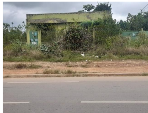
B : Ancienne agence de la caisse nationale des caisses d'épargne CNCE en ruine
